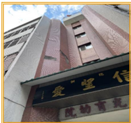
外牆磁磚剝落
